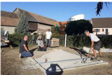
Atelier plateforme pompe à bras
